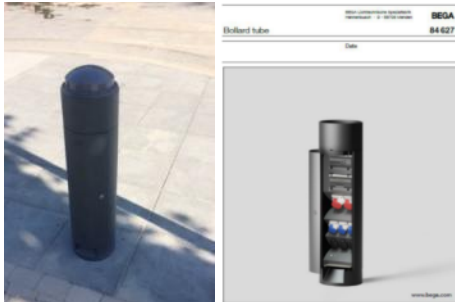
D168. attēls. Elektrības pieslēguma sadalne BEGA. Teh.spec. un uzstādīta. Ogre, Brīvības ielas laukums. Foto – ALPS.
