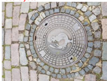
D179. attēls. Komunikācijas šahtas vāks Autoru foto..
