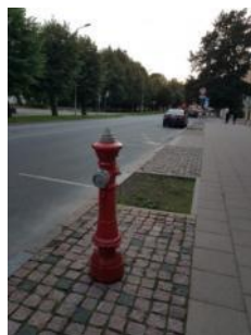
D175. attēls. Ugundzēsības hidrants labiekārtojuma joslā. Elizabetes ielā. Autoru foto.
