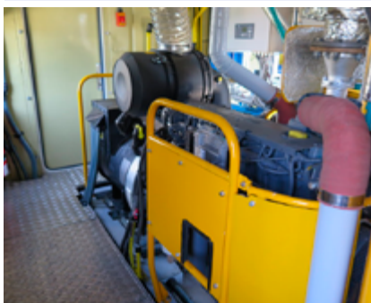
10.5.att. Dīzelģenerators mašīntelpā
