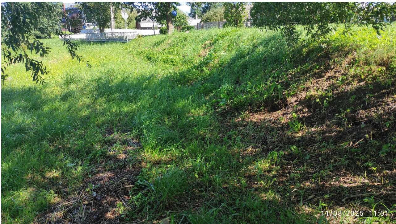
3.Att. Krasta erozijas radīti izskalojumi uzbērtas grunts veidotā nogāzē aptuveni 1,5 m virs normālā upes ūdenslīmeņa (aptuveni 250 m uz ziemeļiem no peldvietas).
